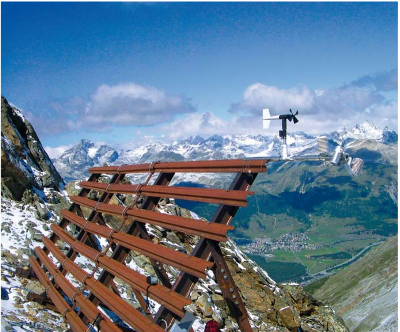
2003 wurden 18 km Stahlschneebrücken als moderne Form der Lawinenverbauung oberhalb von Pontresina installiert, Foto M.Philipps, SLF.
