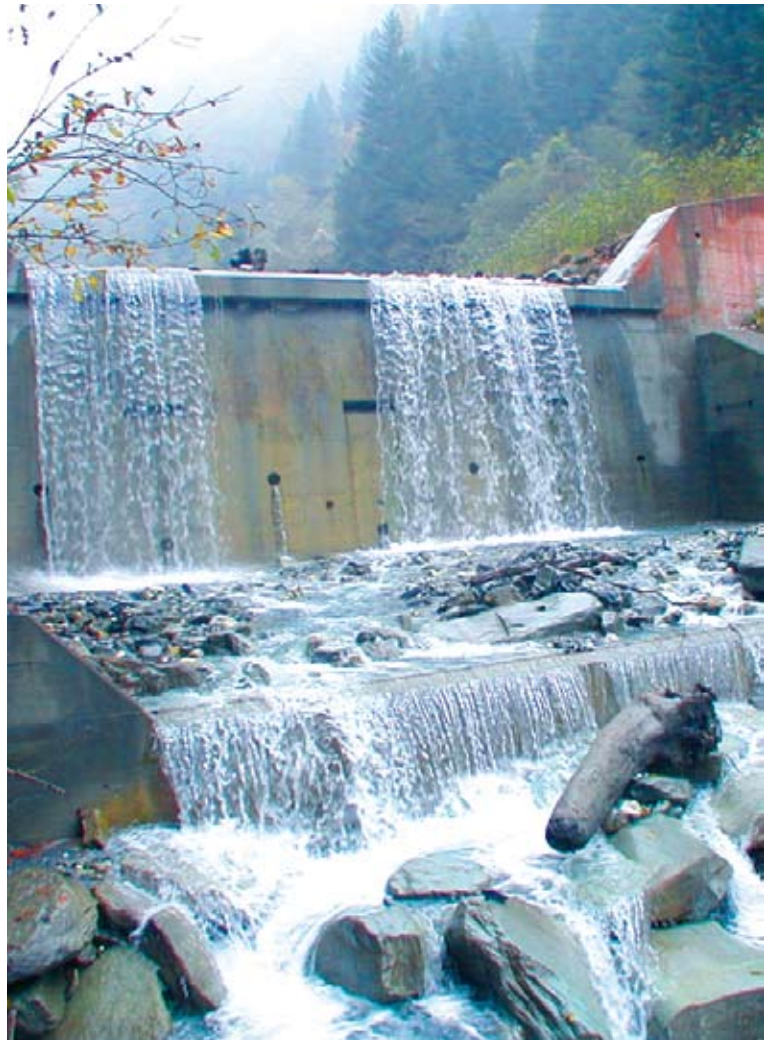
Schutzbauten werden auf eine vordefinierte Grenzbelastung hin bemessen, bis zu welcher keine Schäden auftreten. Für das Verhalten der Schutzbauten im Überlastfall, wenn die Grenzbelastung überschritten wird, verfolgt das TBA verschiedene Schutzkonzepte, Foto TBA, Wildbachsperre in der Nolla.
